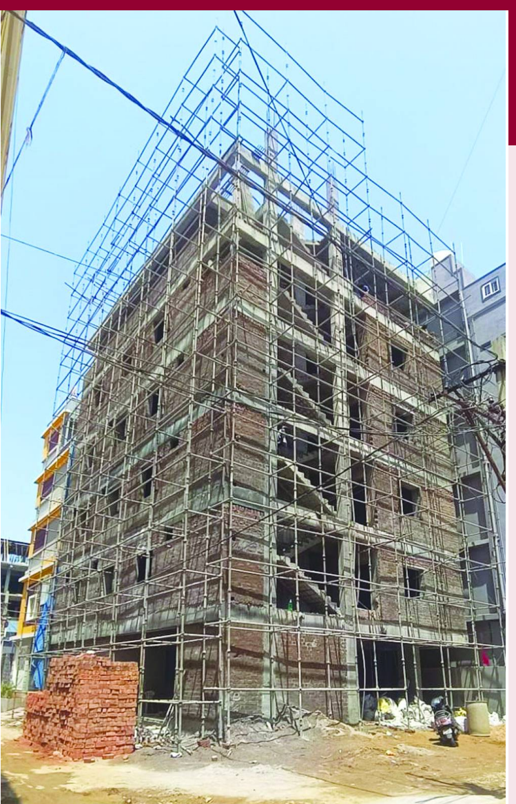
గండిమైసమ్మలో సర్వే నెం.168, నిర్మాణాల నిషేధించిన భూమిలో.. అనుమతుల్లేని అక్రమ బహుళ అంతస్తుల నిర్మాణం..
