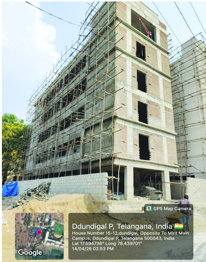
ఎంఎల్ఆర్బిటి ఎదురుగా అనుమతుల్లేని అక్రమ బహుళ అంతస్తుల నిర్మాణం..
