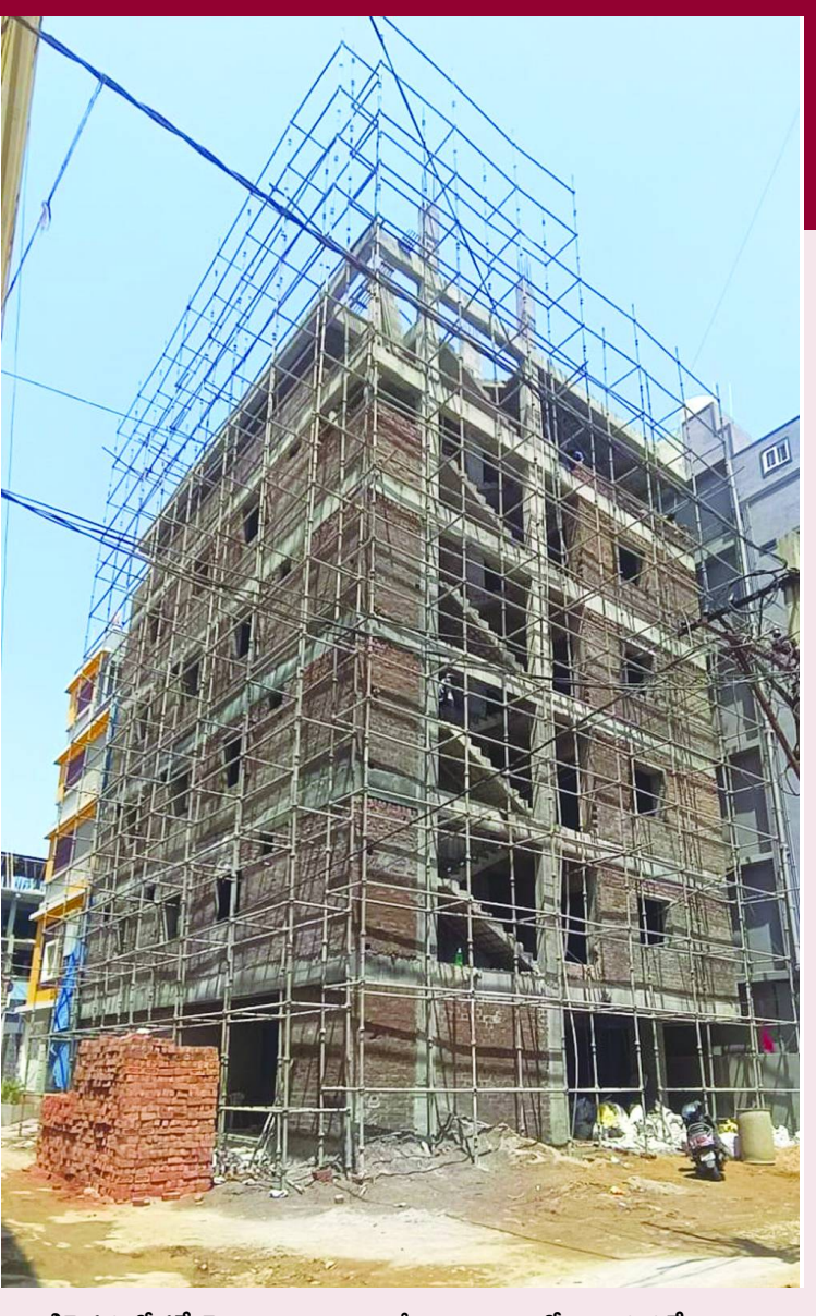
గండిమైసమ్మలో సర్వే నెం.168, నిర్మాణాల నిషేధించిన భూమిలో.. అనుమతుల్లేని అక్రమ బహుళ అంతస్తుల నిర్మాణం..
