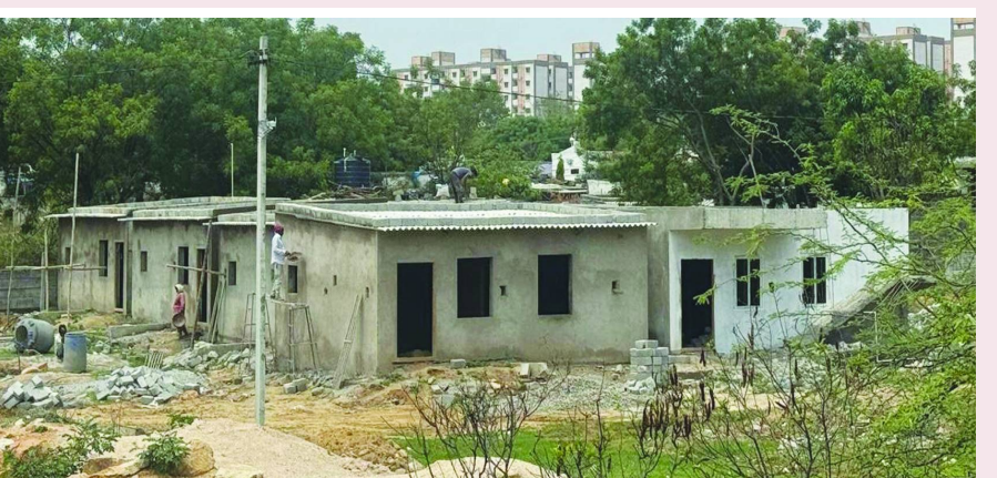
సర్వే నెం.120 గైరాన్ సర్కార్ భూమిలో అక్రమంగా నిర్మించిన అక్రమ నిర్మాణాలు..
